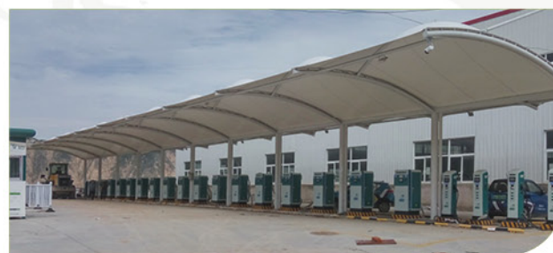
兰州市城关区联合弘物流园充电站
