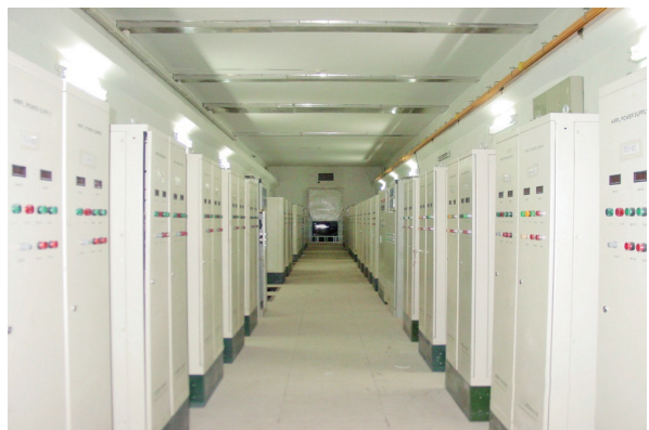
电源运行现场
